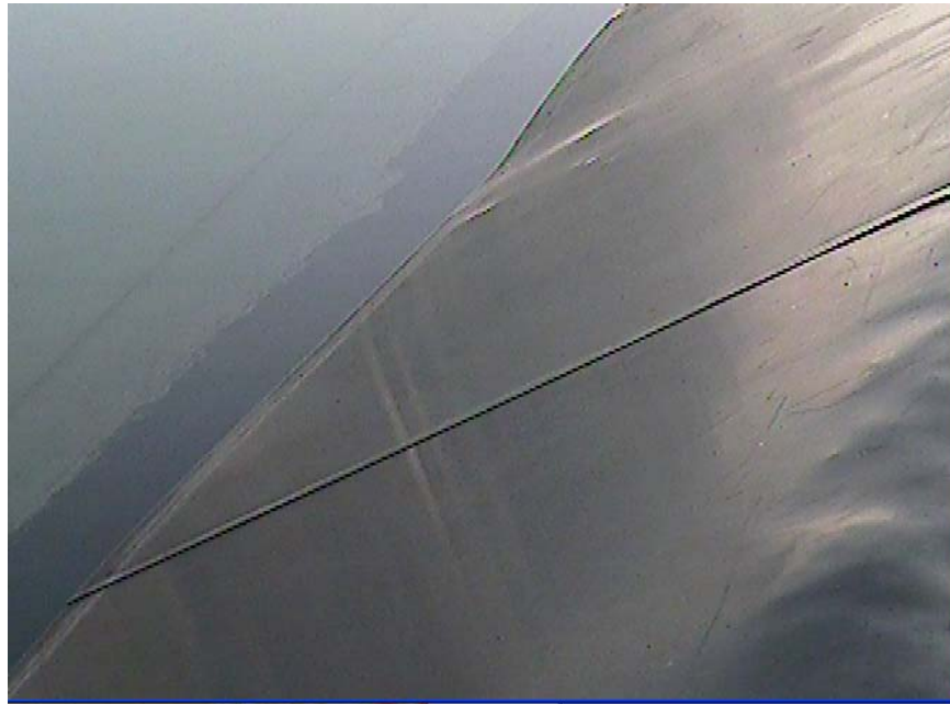
Fig nº 7. Lámina tensada con discontinuidad en soporte de base
