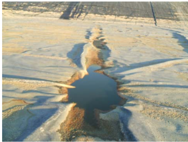
Fig n° 4. Colapsos en drenes
