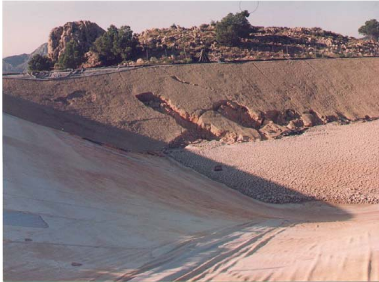
Fig n° 3. Pérdida de soporte.
