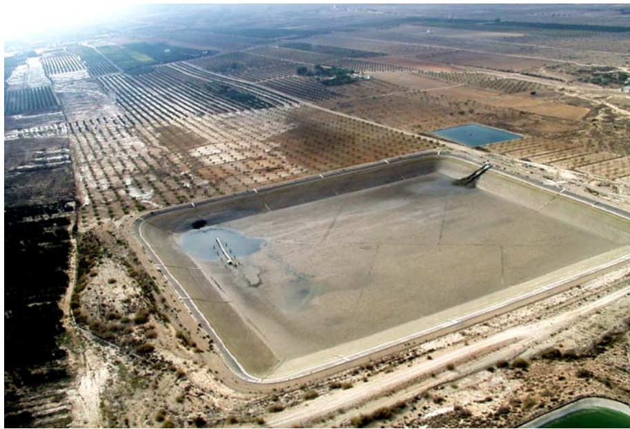
Fig nº 5. Rotura Embalse Loma de las Salinas.
