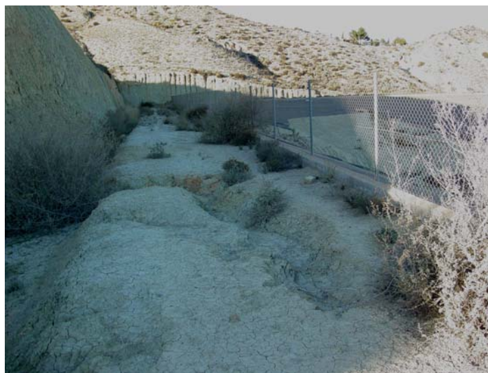
Fig nº 1. Erosión en pasillo de coronación.
