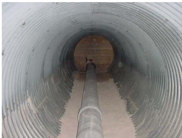
Fig nº 2. Salida de balsa sin sistema de drenaje
