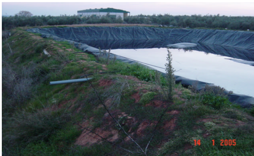
Fig. nº. 4. Salida de gas por debajo del pasillo de coronación.
